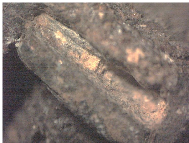
Рис. 4. Следы локального расплавления алюминиевого провода в контактном зажиме
