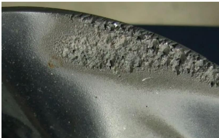
Рис. 4. Эрозия поверхности лопасти рабочего колеса насоса в следствии кавитационных процессов
