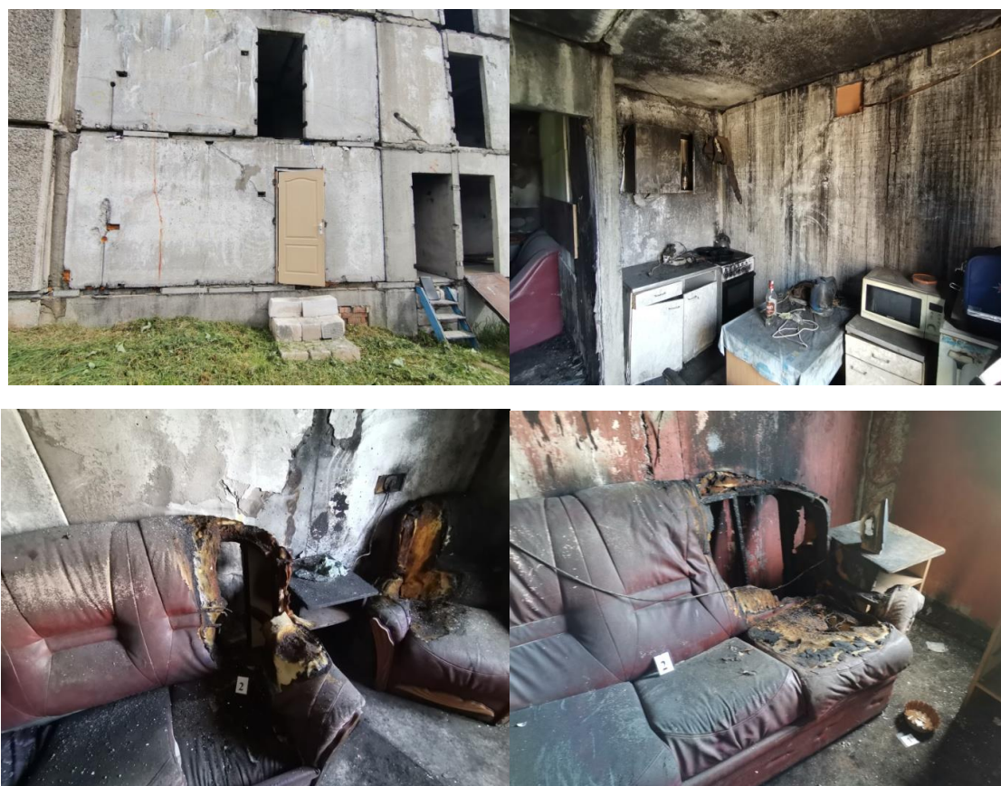
Рис. 4. Смоделированные на площадке № 2 очаги пожара
