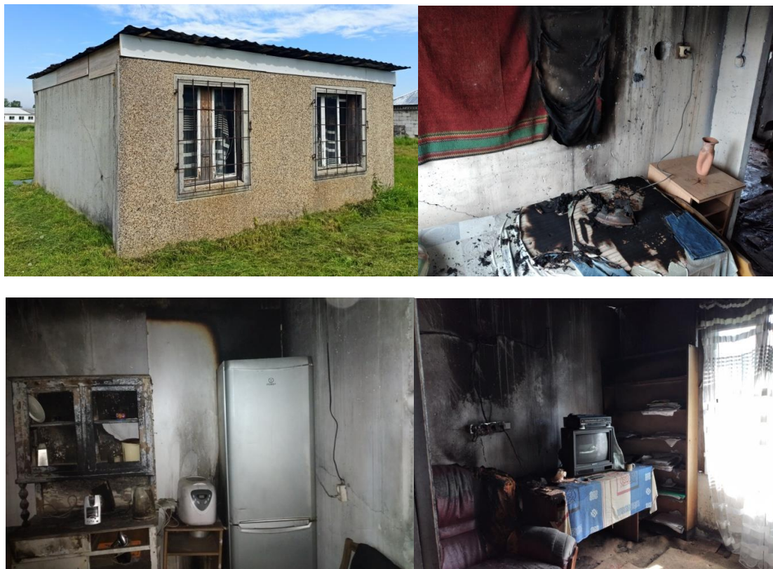
Рис. 3 Смоделированные на площадке № 1 очаги пожара
