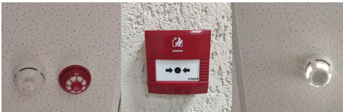
Рис. 2. Тепловой извещатель «Аврора-Т-ПРО» и звуковая сирена «Сирена-ПРО»; ручной пожарный извещатель «ИПР-ПРО»; дымовой пожарный извещатель «Аврора-ДО-ПРО»
