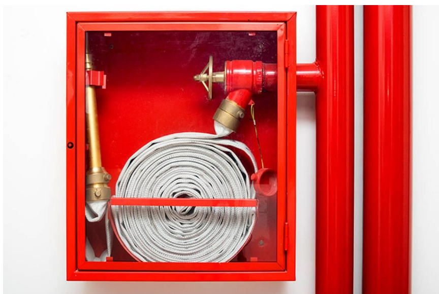
Рис. 4. Пожарный кран внутреннего противопожарного водопровода в здании
