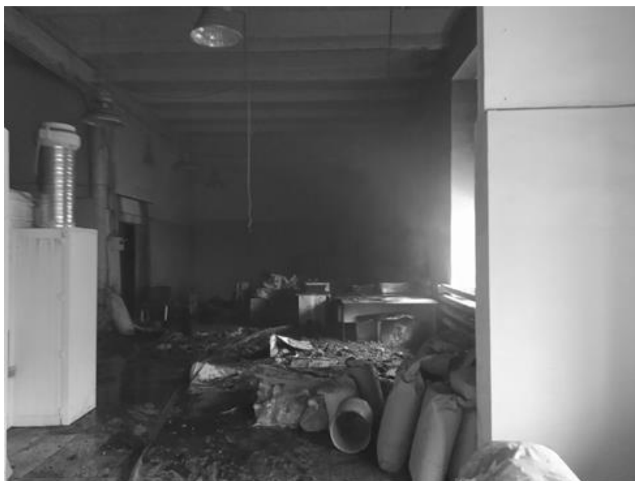
Рис. 6. Комната со следами термических повреждений
