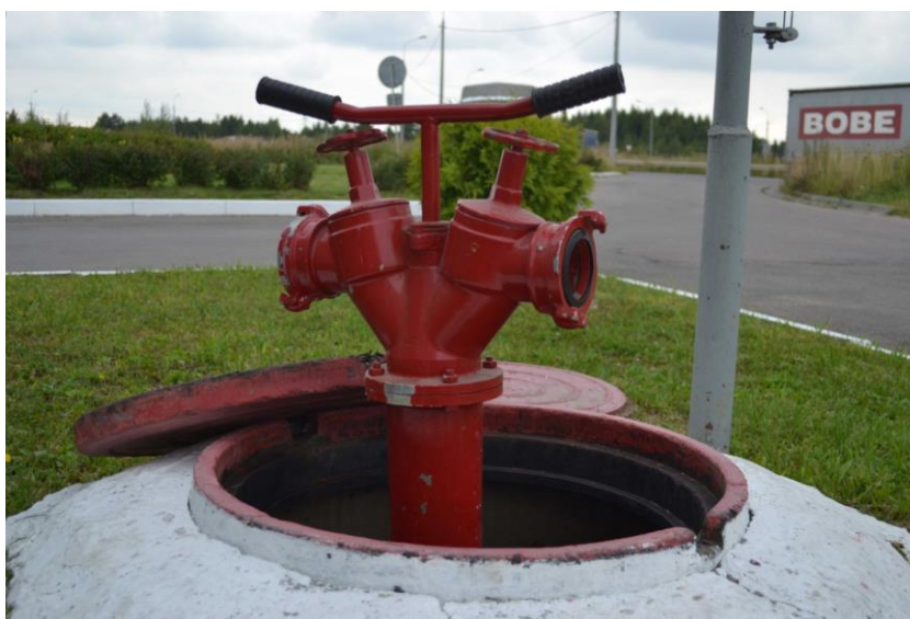
Рис. 1. Наружное противопожарное водоснабжение (пожарный гидрант)
