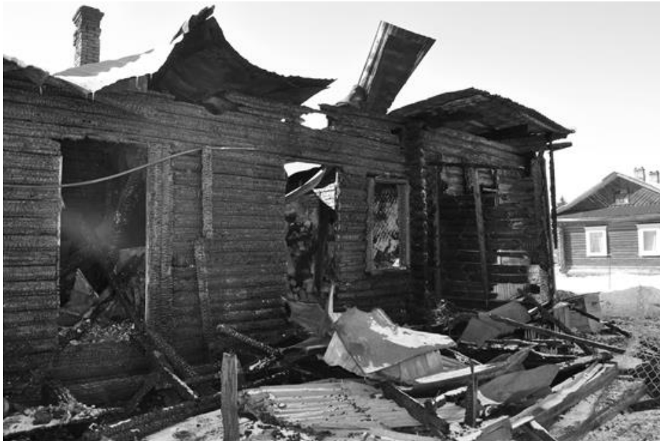
Рис.4. Следы термических повреждений центральной части северной стены дома
