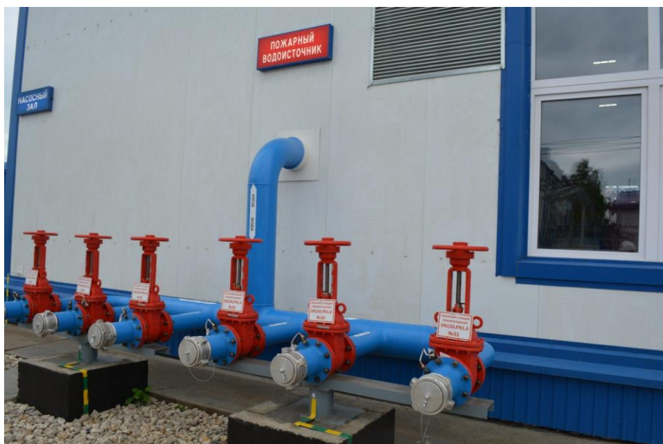
Рис. 3. Внутренний противопожарный водопровод на предприятии
