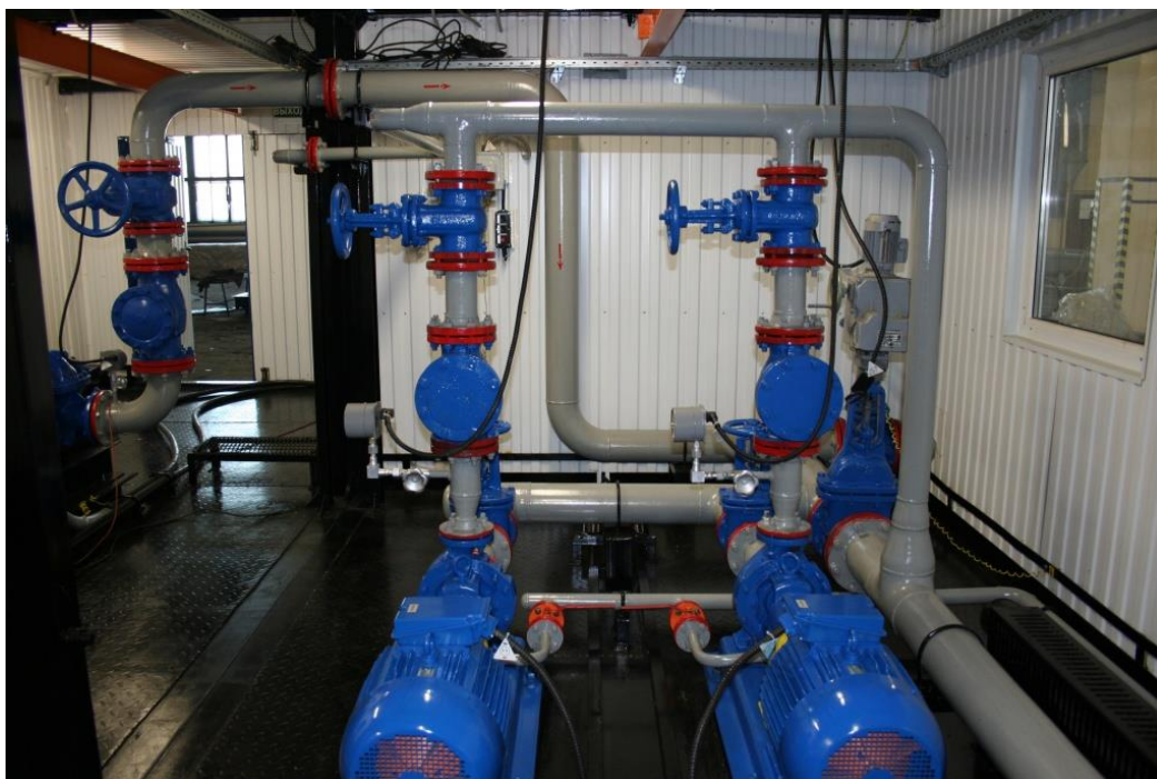
Рис. 5. Насосная станция пожарного водоснабжения
