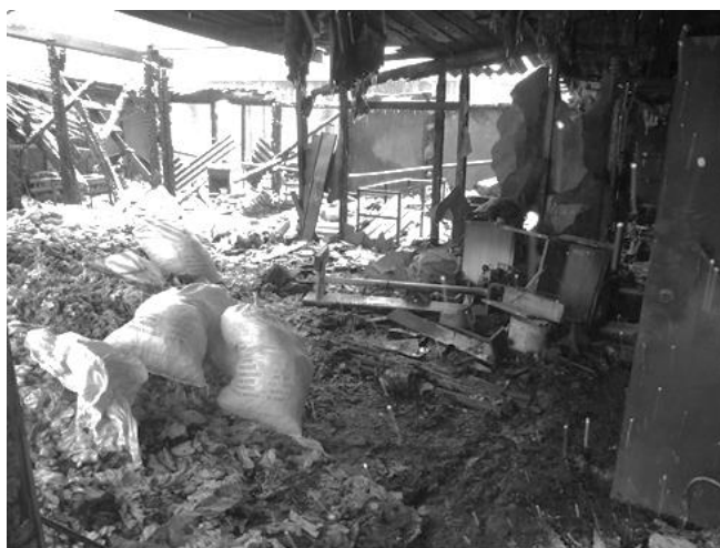
Рис.2. Следы термических повреждений внутри помещения склада
