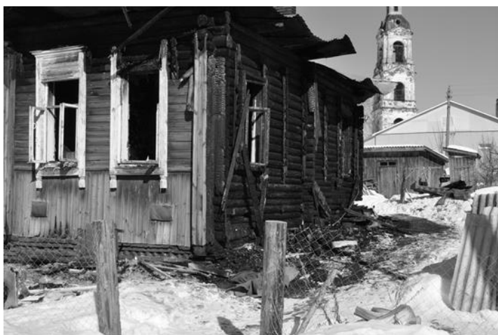
Рис. 3. Следы термических повреждений юго-восточной стены дома
